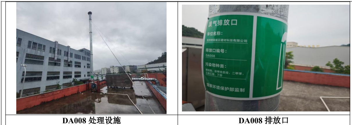
图 3-2 废气处理设施现场图
