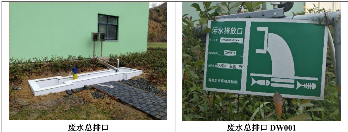
图 3-5 废水总排口现场图
