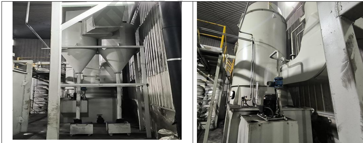
抛丸废气旋风+湿式重力除尘处理设施
