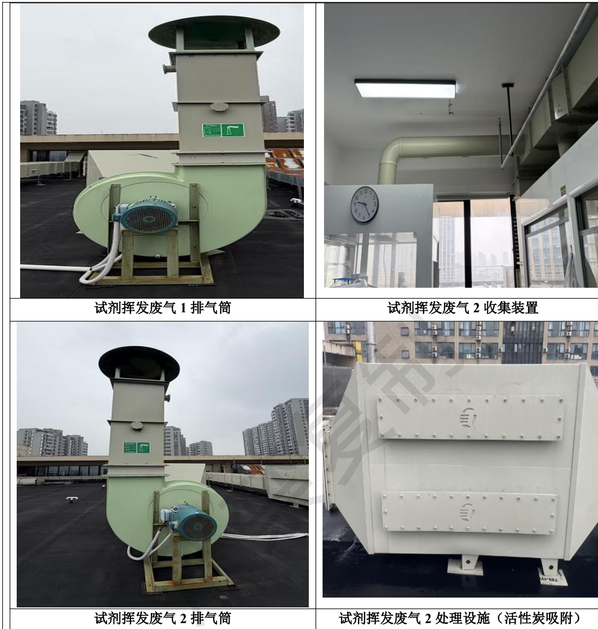
图 3-2 废气处理设施现场图
